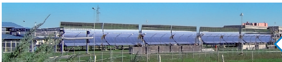
Figura 3. Modulo dell'impianto Archimede in fase sperimentale presso il centro di ricerca Enea della Casaccia. Archimede, della Potenza di 5 MWe, in costruzione da parte di Enel a Priolo Gargallo (Siracusa), è il primo impianto al mondo a utilizzare i sali fusi nel tubo ricevitore/caldaia di un sistema solare a concentrazione parabolico lineare. La sua entrata in funzione è prevista il prossimo maggio.
